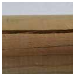
Cracks/Grietas/Fente/Risse/ Crepe/ Barsten/Fendas
